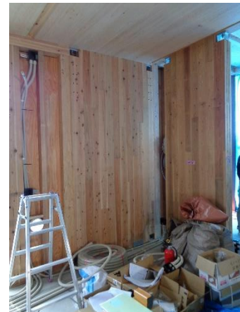
X4~5×Y6 通 外壁 : CLT 5層 5プライ 杉 No.9 耐力壁のみ、No.16 は軸組壁に変更
