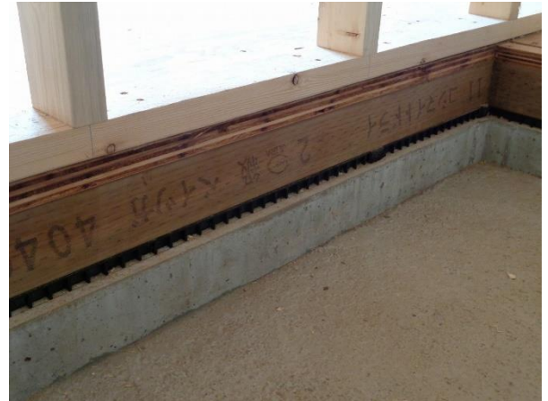
X7~8×Y9 通 1階 土台： JAS 目視等級 構造用製材 ベイツガ（対象外）
