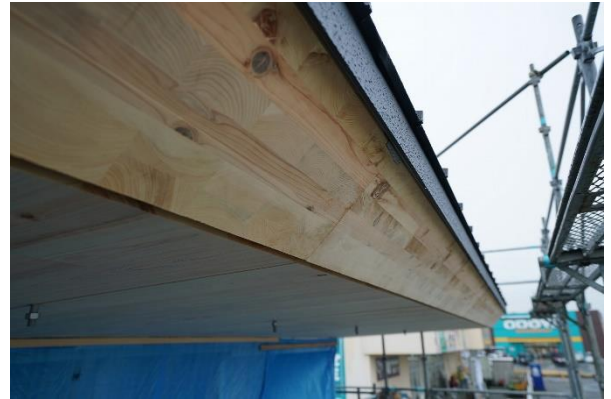
軒先あらわし (水切り彫り込み) 屋根版： CLT 5層7プライ 杉+桧
