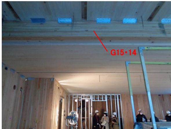
X5×Y3~6 通 梁 G15 : JAS 構造用集成材 (中断面) 屋根 : CLT 5層7プライ 杉+桧
