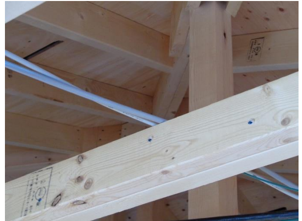
X5~8×Y7~8 2階 天井根太・垂木： JAS 桢組壁工法構造用製材 204、208 SPF
