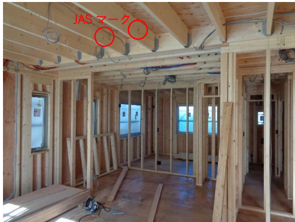
X0~5×Y6~11 通 1階 縦枠・上下枠・根太 JAS 枠組壁工法構造用製材 SPF
